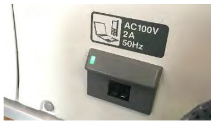
図28 壁に設置されたコンセント
